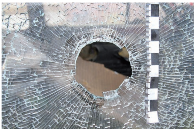
Ryc. 45. Zbliżenie na ww. przestrzał szyby. Widoczne są promieniste oraz koncentryczne pęknięcia szyby.
