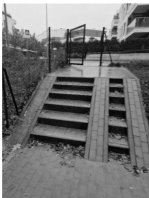
Fot. 19. Schody uniemożliwiające dostęp do urządzeń (lokalizacja G7)
